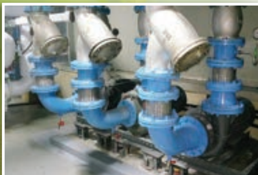
改善後新設冷卻水泵25HP
