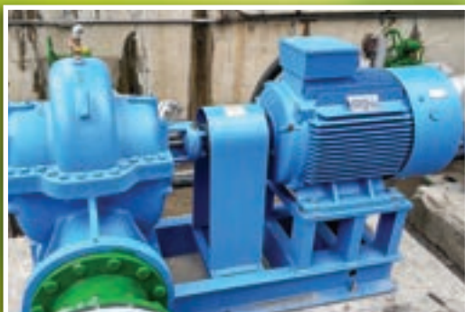
改善後新設冷卻水泵40HP
