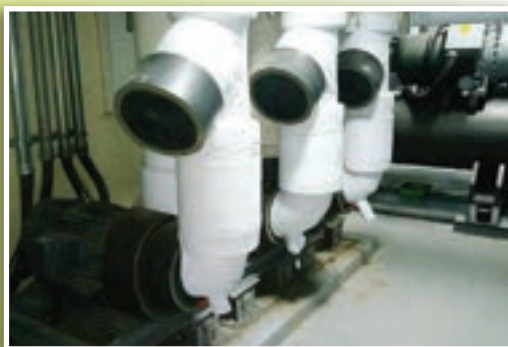
改善後新設冰水泵25HP
