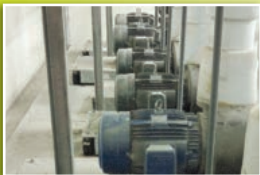
改善前冰水泵20HP、冷卻水泵25HP
