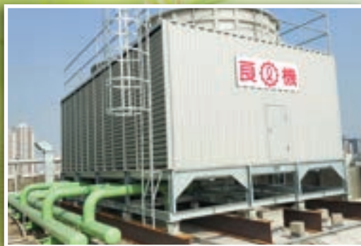
改善後新設冷卻水塔800RT
