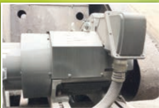
改善後新設變頻式集塵風機300HP
