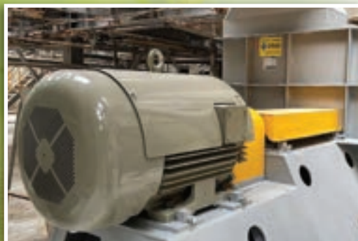
改善後新設風機100HP
