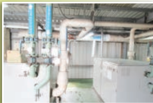
改善前東側冰水主機60RT
