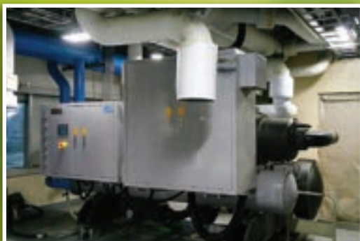
改善後新設冰水機240RT
