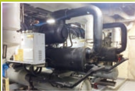
改善前冰水機240RT
