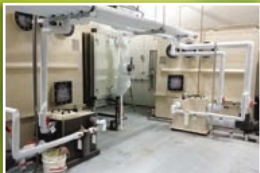
改善後新設外氣除溼設備
