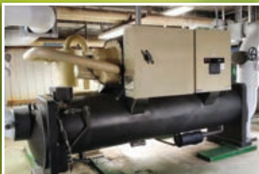
改善後新設冰水主機276RT
