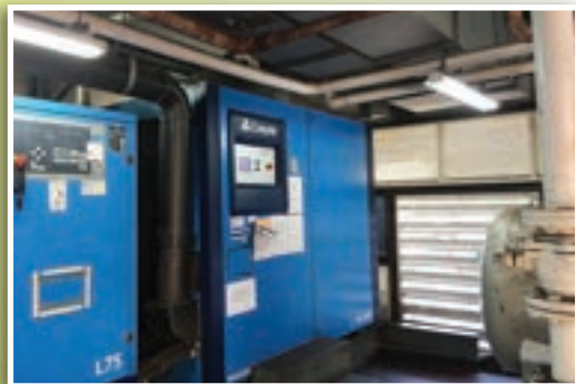
改善後新設變頻式空壓機100HP
