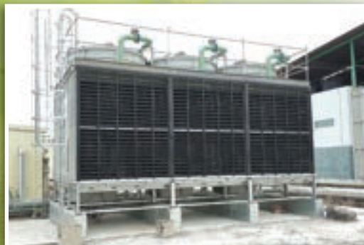
改善後新設冷卻水塔200RT
