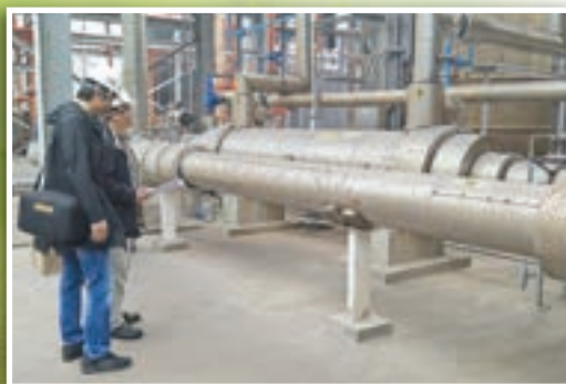
新設廢熱回收裝置
