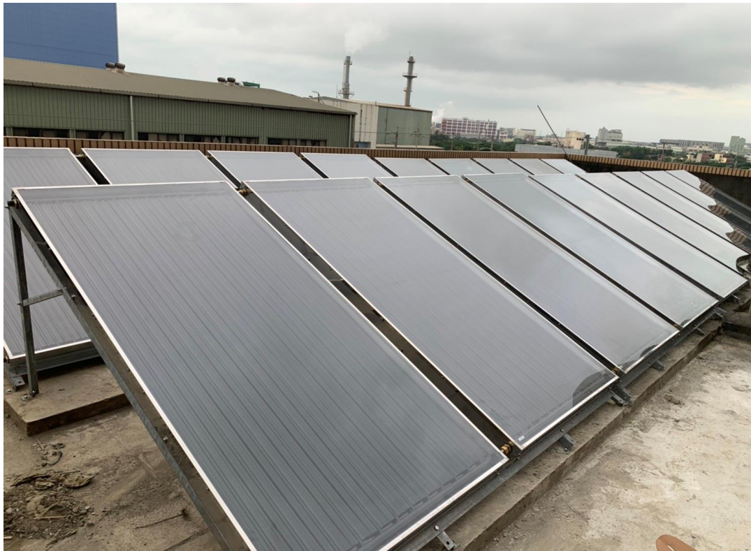
新東陽大園廠男女生宿舍熱水系統改善工程 回收年限:3.5 年
