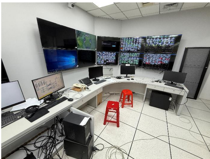
【竣工照片－中控室 KVM 戰情監視系統】
